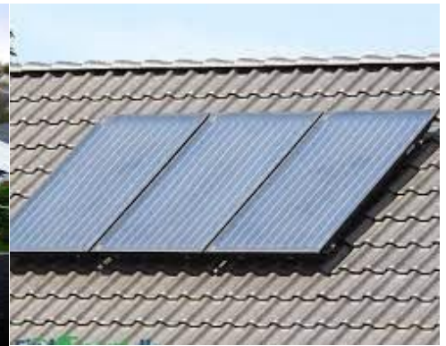
Solvarme til varmt vand og tilskud til rumvarme
